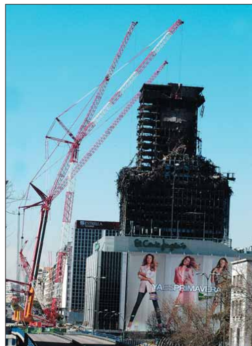
Los robots pueden realizar tareas peligrosas. En la imagen, demolición controlada del edificio Windsor, en Madrid.
